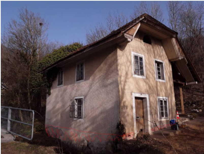
Abbildung 3: Beschädigung des Putzes im Sockelbereich
