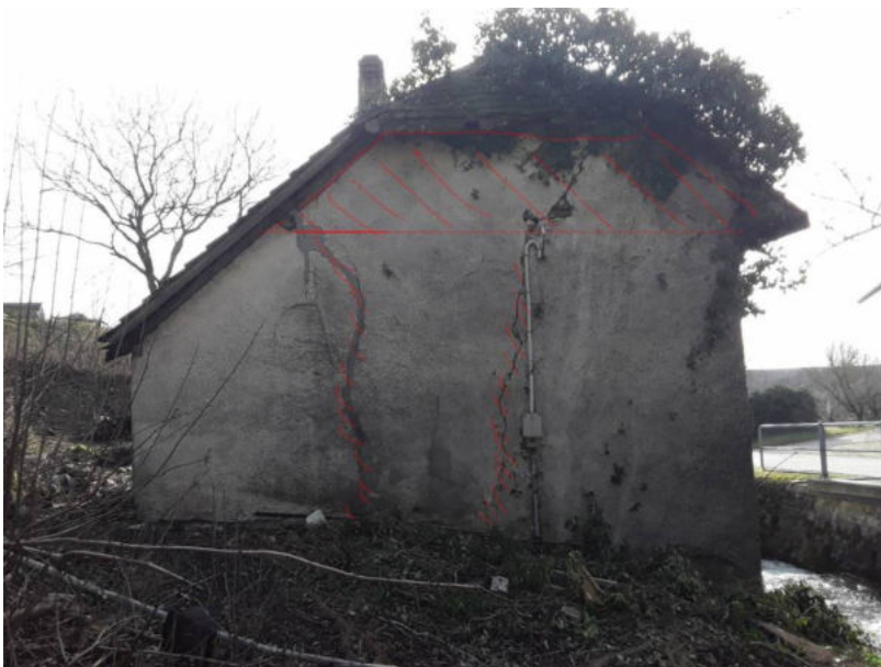
Abbildung 4: Risse im Putz nordseitig
