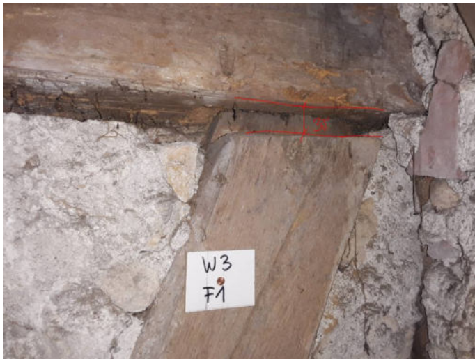
Abbildung 20: Senkung der Konstruktion an der Ecke Wand 2 und 3
