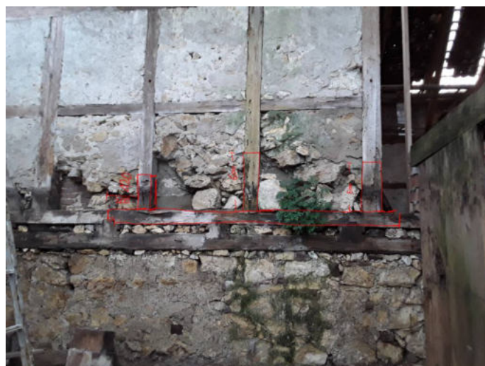
Abbildung 14: Schäden an der Wand 1 aussenseitig
