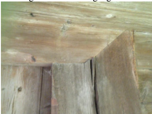
Stauchung beim Türgewände im Obergeschoss
